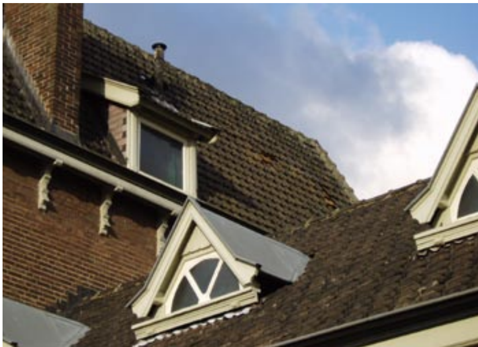
Het dak voor de renovatie: afbladderend houtwerk, versleten zink en kapotte dakpannen.
